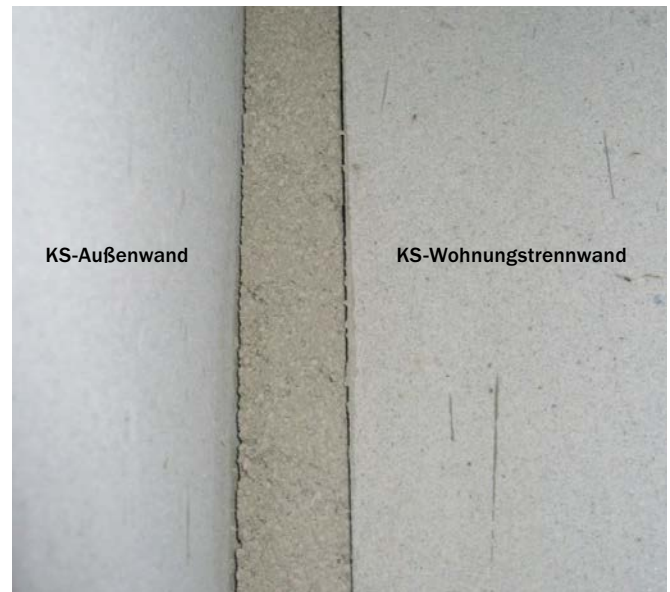
Bild 22: Wohnungstrennwand an Außenwand mit beidseitig gelöster Mörtelfuge
