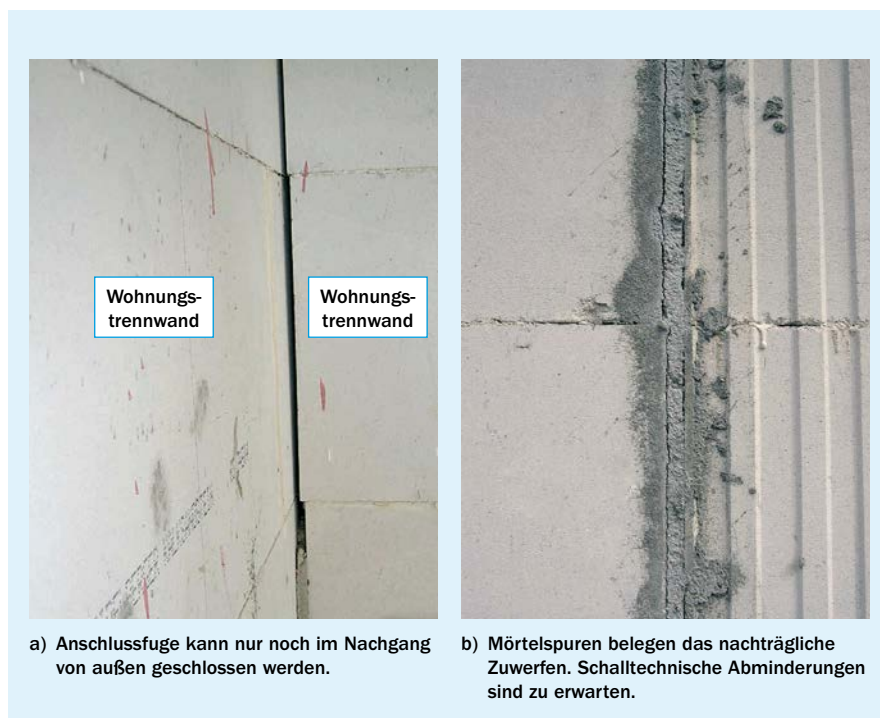
Bild 26 Fehlerhafte Ausführung des Stumpfstoßes: a) fehlende Vermörtelung, b) nachträgliche Vermörtelung
